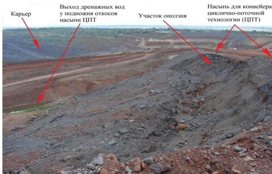
Рисунок 2 – Оползень насыпи ЦПТ
